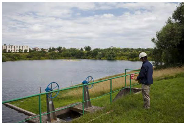
LDE IDF Ouest Val de Seine - site de production d'eau potable du Pecq-Croissy, agent sur le site de la Coulée verte devant le poste des vannes du bassin de réalimentation de la nappe
