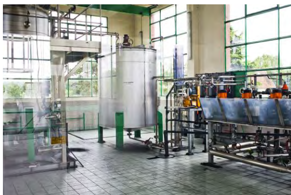
LDE IDF Ouest Val de Seine - site de production d'eau potable du Pecq-Croissy
